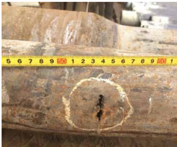
Рис. 1: Промыв бурильной трубы Fig 1: Drill pipe washout
